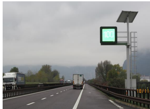
Abbildung 1 Photovoltaik-Hinweis zur Anzeige der empfohlenen Geschwindigkeit.
